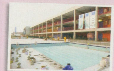
ITAQUERA - Distrito: Cidade Líder Plano de Obras 2002 CEU Aricanduva (concluído) Av. Aricanduva
