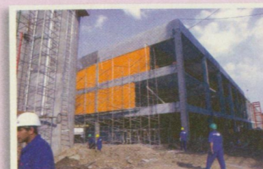
ITAIM PAULISTA - Distrito: Vila Curuçá Plano de Obras 2002 CEU Vila Curuçá (em obras) Av. Marecha Tito
